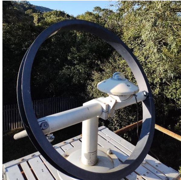
Figura 2: Piranômetro com anel de sombreamento acoplado para realizar medição de radiação solar difusa horizontal.
