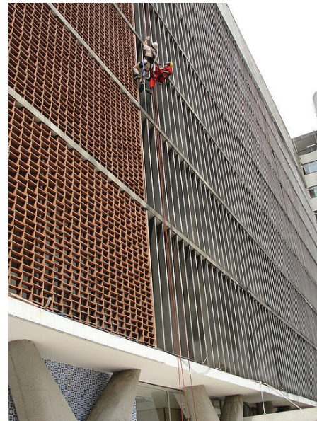
03.126 - Levantamento das patologias da fachada através de rapel. Fonte: Astorga Arquitetura e Restauração.
