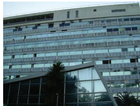
03.06 - Fachada antes da reforma, cobertura com aberturas não previstas em projeto. Foto: Elsa Costeira.
