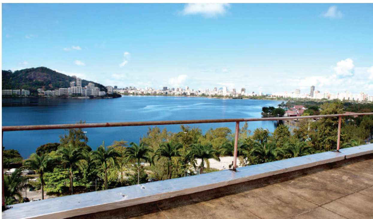
03.116 - Cobertura do Hospital da Lagoa, laje precisou passar por processo de impermeabilização cuidadoso para sanar problemas de infiltração. Fonte: Acervo Ministério da Saúde
