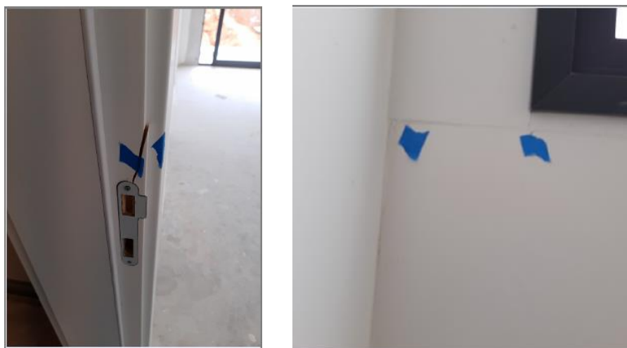
Figura 22 e 23: Defeitos de marco de porta e cerâmica quebrados.
