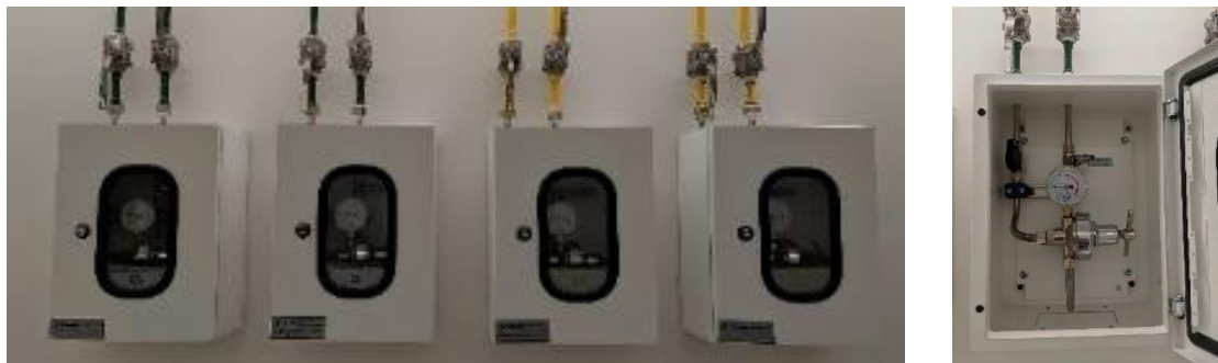
Figura 12: Figura A, à esquerda, com duas redes de oxigênio(O 2 ) na cor verde e duas redes de ar comprimido (AC) na cor amarelo. Figura B, à direita, com a válvula de pressão da rede.
