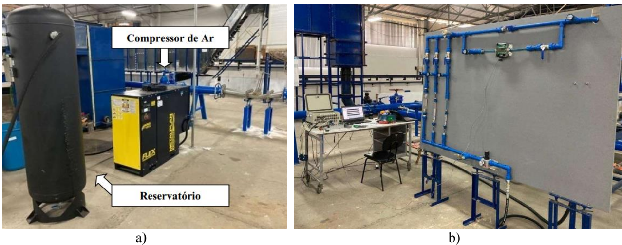
Figura 4.- a) Compressor e reservatório de ar comprimido; b) Quadro de medição de ar e sistema de aquisição de dados.
