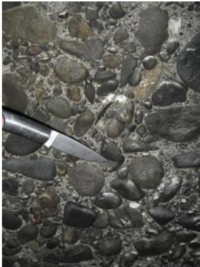
Figura 1 - Superfície de concreto com dano causado por abrasão. Fonte: VON FAY, 2015.
