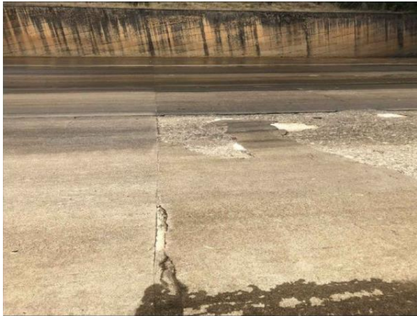
Figura 12 - Dano na calha do vertedouro em região intermediária da calha. Fonte: Projeto Estudo de Concreto para Superfícies Hidráulicas - RELATÓRIO DE PRODUTO ETAPA 2 – ANÁLISE BIBLIOGRÁFICA (R2.1) - IPH/UFRGS VERSÃO 1/PARTE 01.
