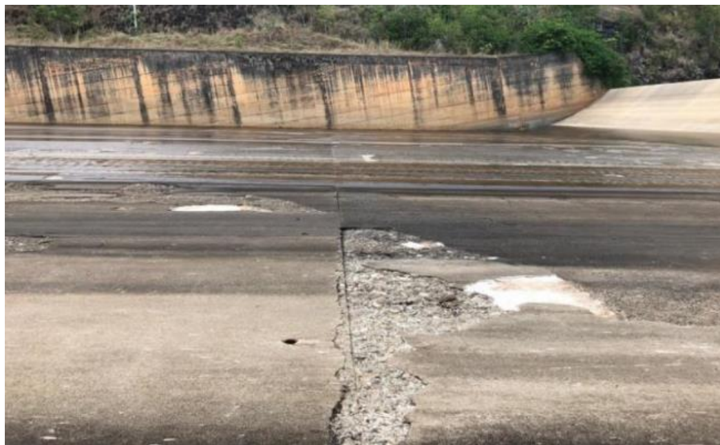
Figura 13 - Dano na calha do vertedouro no segmento mais a jusante. Fonte: Projeto Estudo de Concreto para Superfícies Hidráulicas - RELATÓRIO DE PRODUTO ETAPA 2 – ANÁLISE BIBLIOGRÁFICA (R2.1) - IPH/UFRGS VERSÃO 1/PARTE 01.
