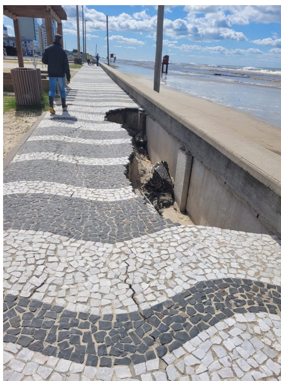
Figura 45 – Fotografia do estrago provocado pelo temporal em Tramandaí 2022.
