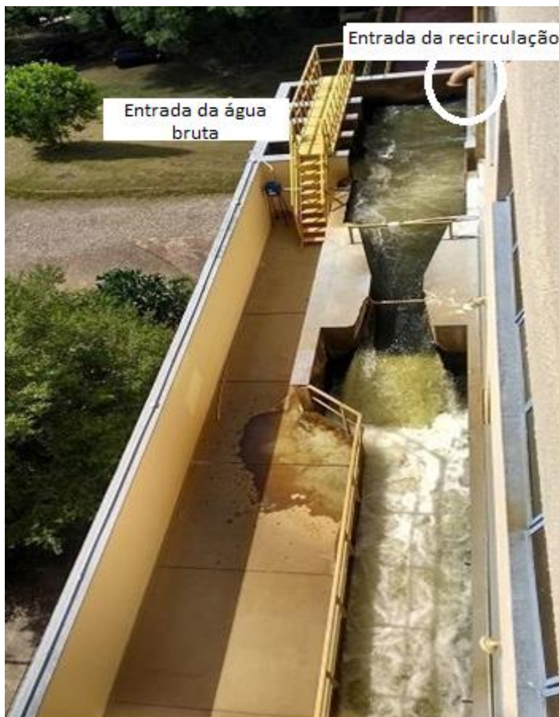
Figura 12 - Detalhe dos pontos de entrada da água bruta e da água recirculada da ETA – Santa Maria/RS
