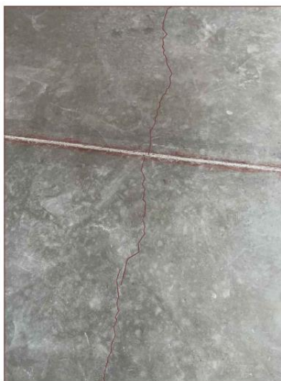
Figura 51 - Fissura por retração devido a ineficiência das juntas
