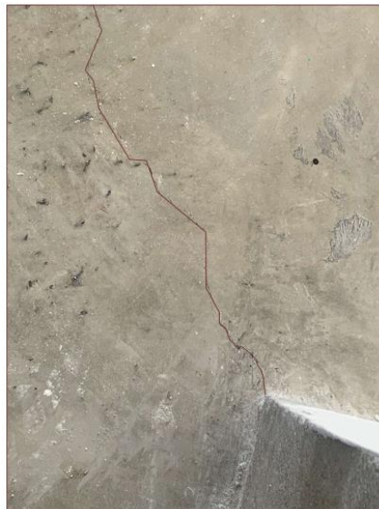
Figura 49 - Fissura saindo de aresta de pilar
