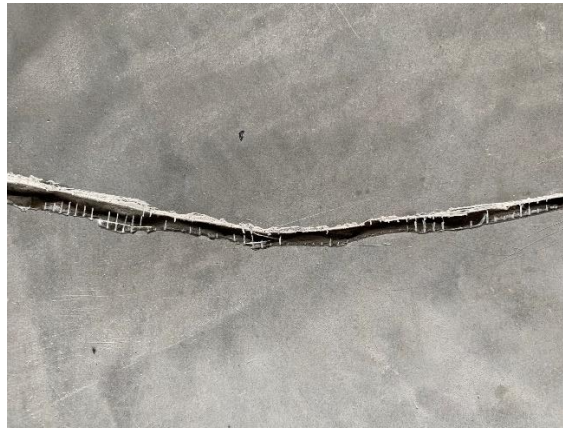
Figura 56 - Abertura de fissuras em piso cimento queimado
