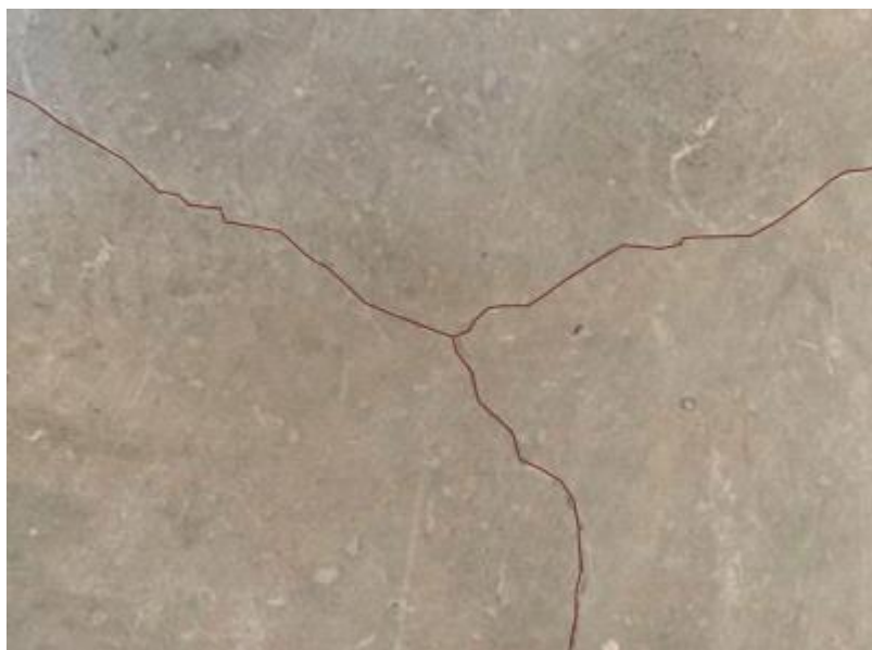
Figura 46 - Encontro de fissuras em piso de concreto polido
