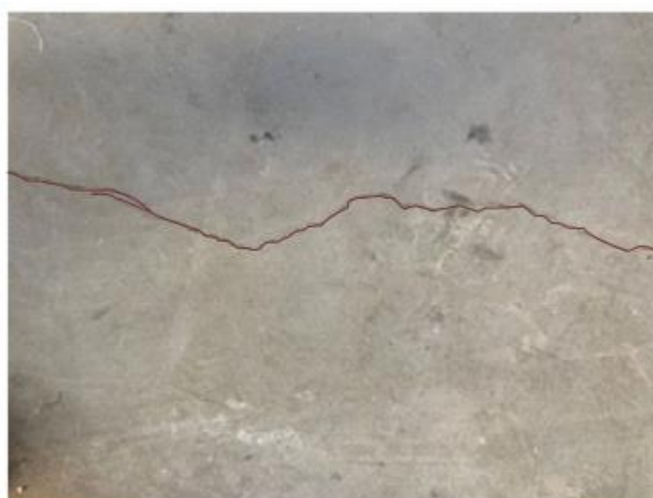
Figura 47 - Fissura em piso de concreto
