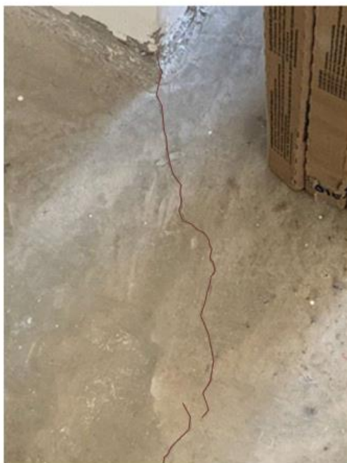
Figura 45 - Fissura partindo da quina de coluna
