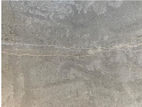
Figura 54 - Fissuras em revestimento monolítico espatulado
