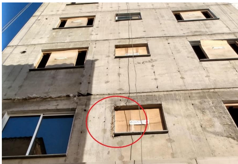
Figura 24 – Armação exposta observado na obra 1
