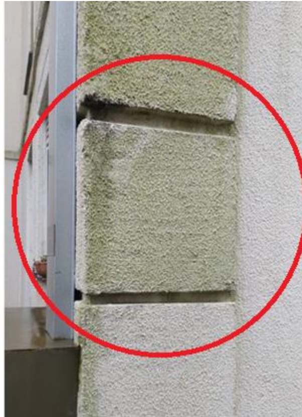
Figura 26 – Provável crescimento biológico na moldura da fachada da obra A
