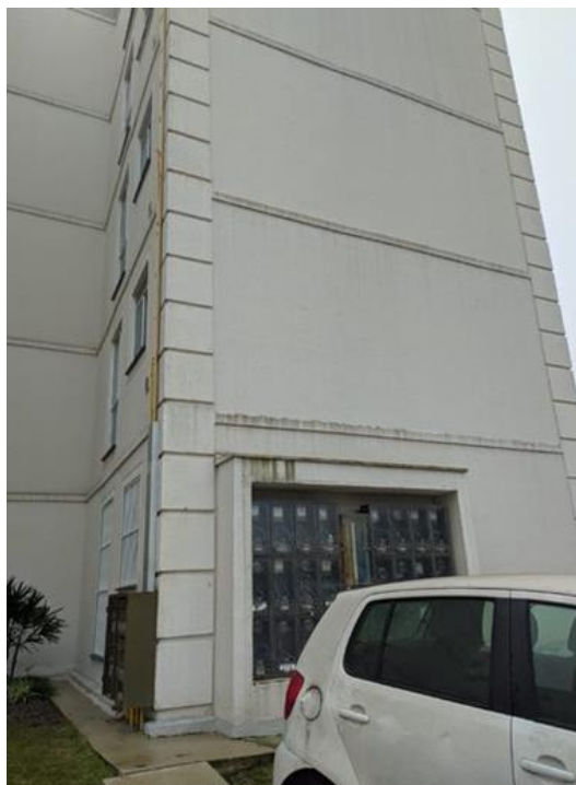
Figura 20 – Sujidade na fachada da obra C
