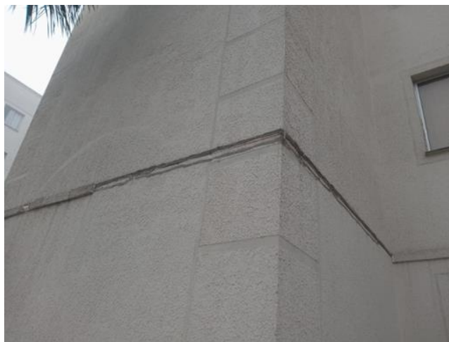
Figura 30 – Moldura descolada na fachada da obra A
