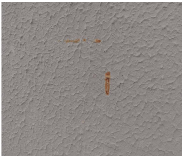
Figura 23 – Ponto de ferrugem na fachada da obra C
