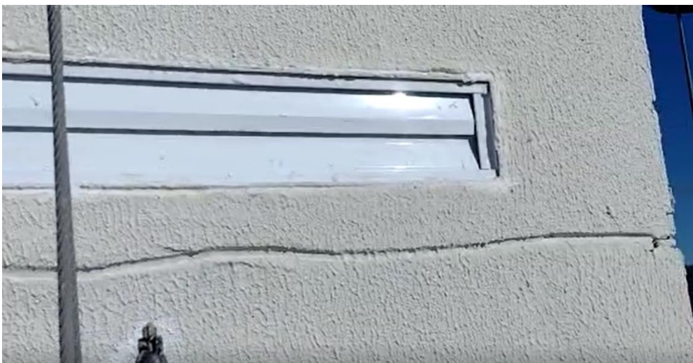
Figura 19 – Friso entre pavimentos irregular após a execução da pintura
