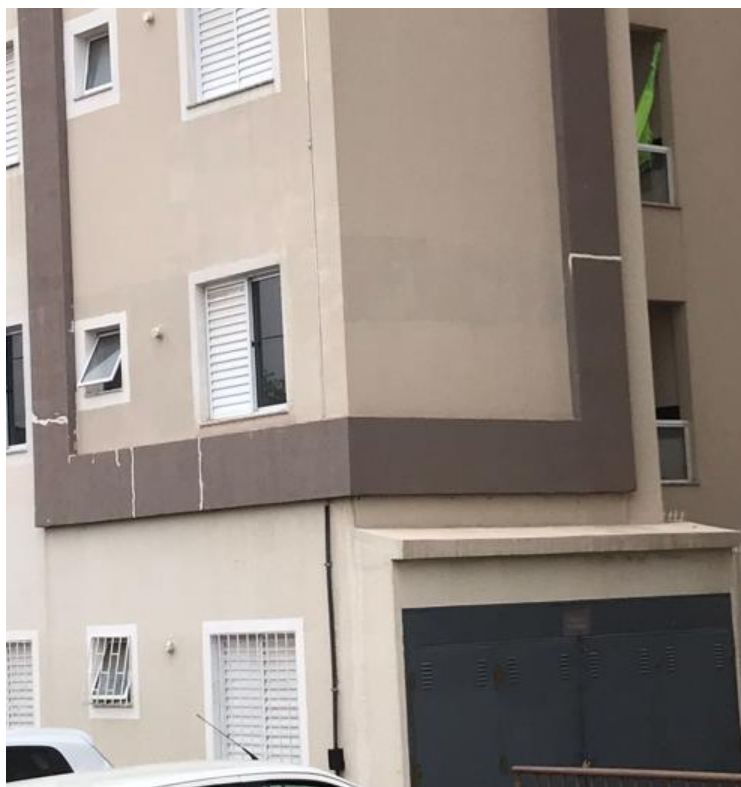
Figura 29 – Fissuras na moldura EPS e alteração de cor na fachada da obra B
