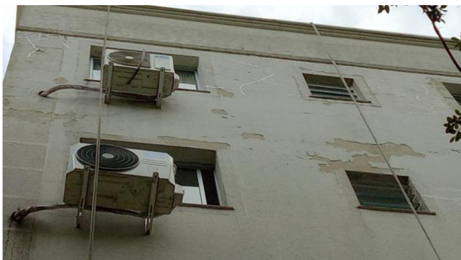
Figura 31 – Descolamento da textura na fachada da obra A
