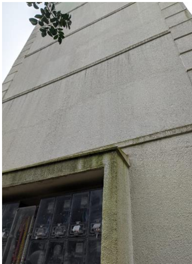
Figura 25 - Biofilme na fachada Sul da obra A
