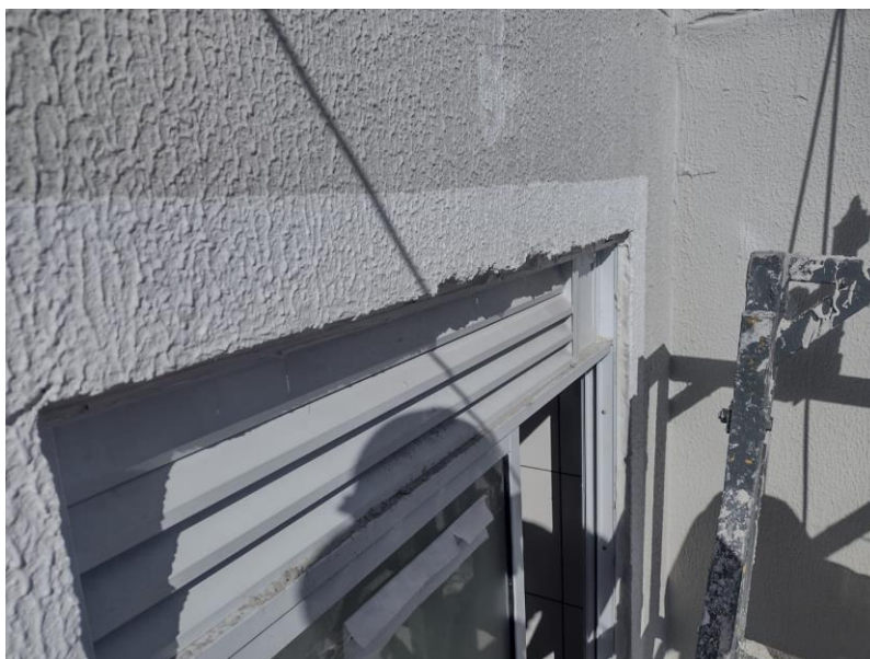
Figura 18 – Detalhe da pintura no entorno janela
