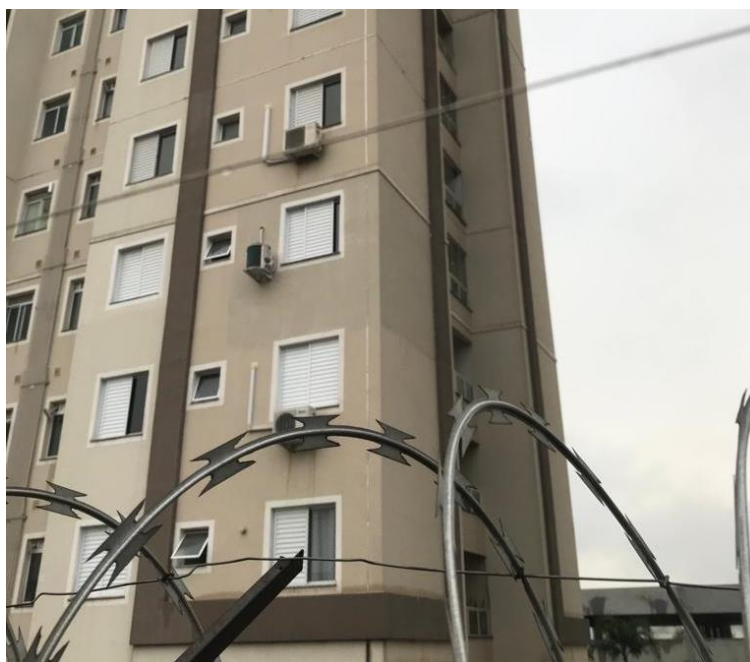
Figura 28 – Alteração de tonalidade na fachada da obra B
