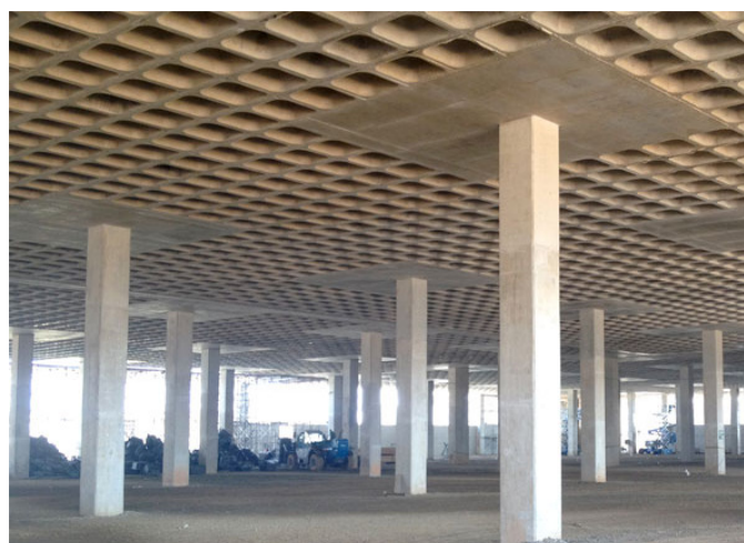
Figura 33 - Imagem face inferior da laje nervurada
