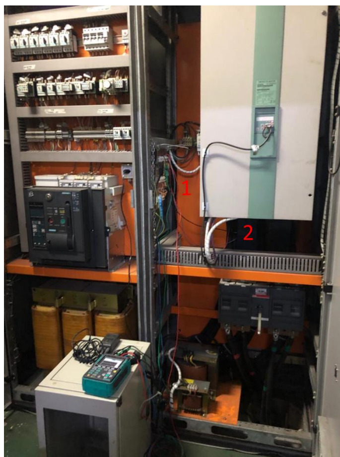
Figura 33 - Montagem do analisador de energia na Gaiola A3.
