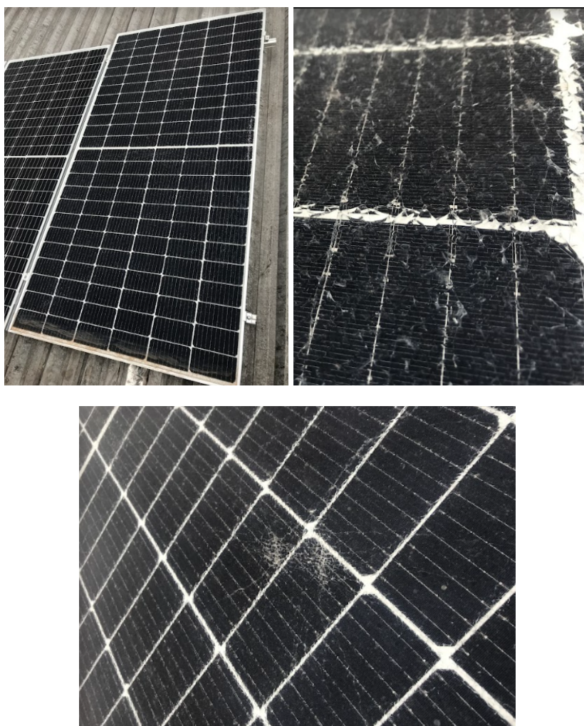
Figura 11 - Registros fotográficos do módulo fotovoltaico danificado analisado
