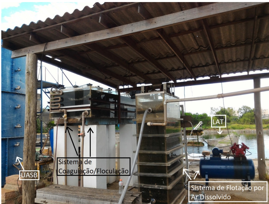
Figura 1. Sistema piloto de tratamento de efluentes.
