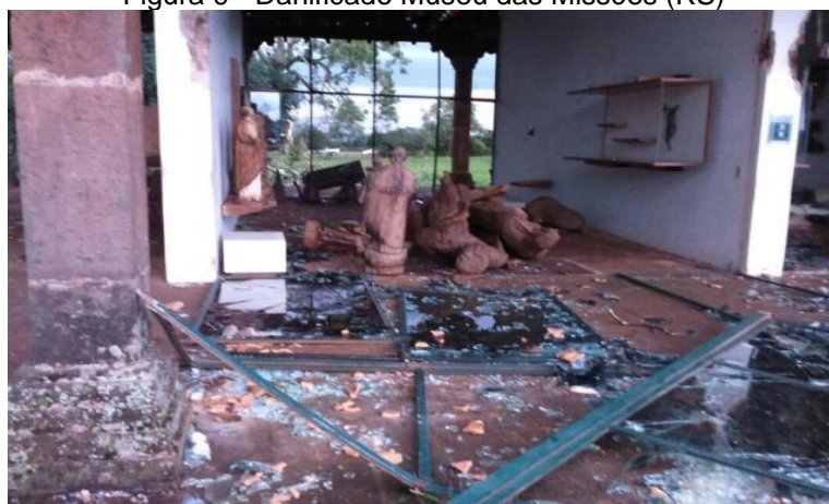
Figura 9 - Danificado Museu das Missões (RS)
