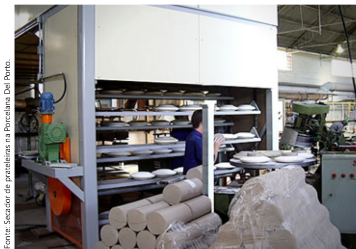
FIGURA 5.22 Secador contínuo. Pratos úmidos nos moldes de gesso são carregados nas prateleiras perfuradas.
