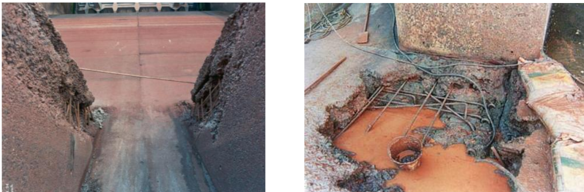
Figura 13: Erosão no pé da barragem de Porto Colômbia, MG. Fonte: Large Brazilian Spillways (2002).
