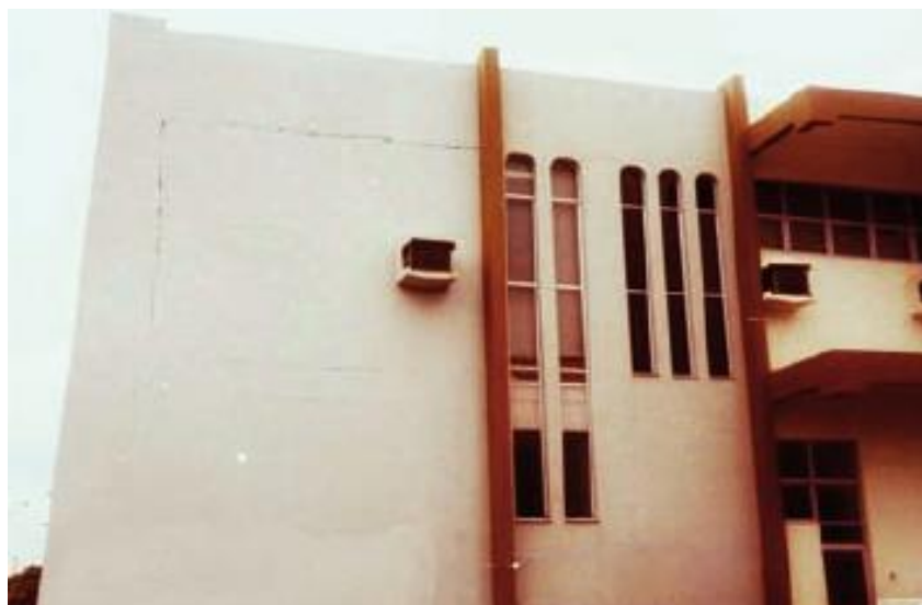
Figura 12 – Destacamento entre alvenaria, viga e pilar.
