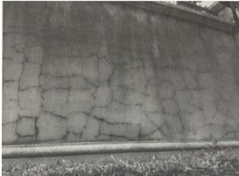
Figura 15 – Fissuras por retração em argamassas de revestimento, com aberturas na ordem de 0,2 mm a 0,4 mm.
