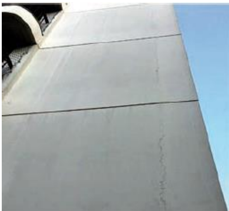
Figura 11 – Destacamento entre alvenaria e pilar.
