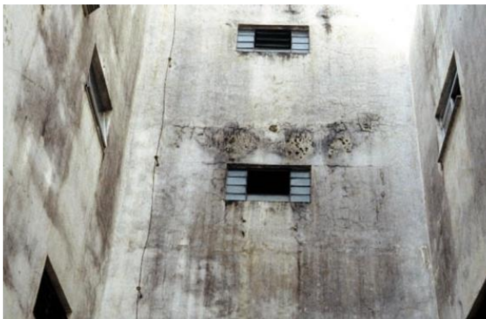
Figura 8 – Revestimento argamassado em adiantado processo de degeneração devido à presença de umidade.
