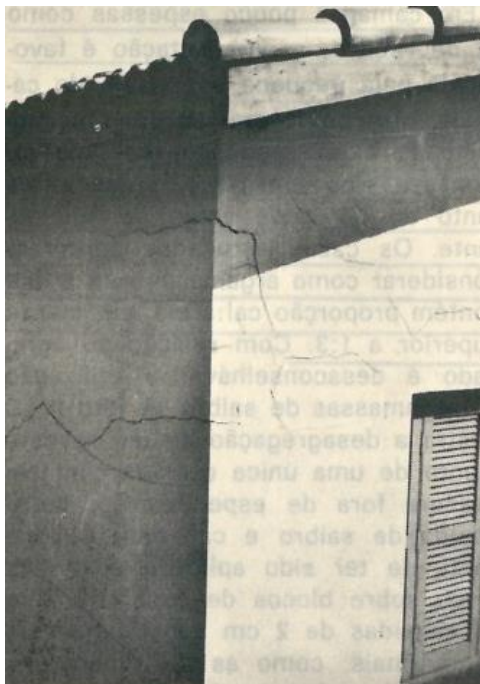
Figura 10 – Fissuras em revestimento argamassado externo causadas por expansão da argamassa de assentamento.
