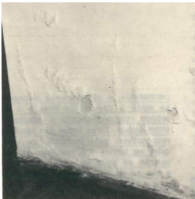
Figura 7 – Revestimento com descolamento por empolamento.
