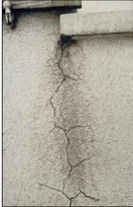
Figura 9 – Fissuração da argamassa de revestimento provocada pelo fluxo de água através de peitoril de janela.
