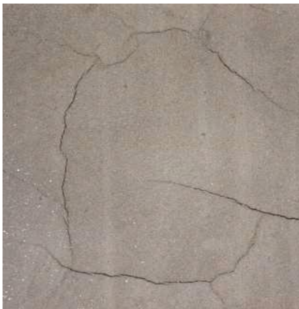
Figura 13 – Revestimento com fissuração mapeada, típica de argamassas com alta retração.
