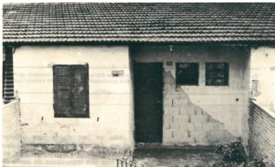
Figura 6 – Revestimento com descolamento em placas devido à falta de aderência com chapisco.
