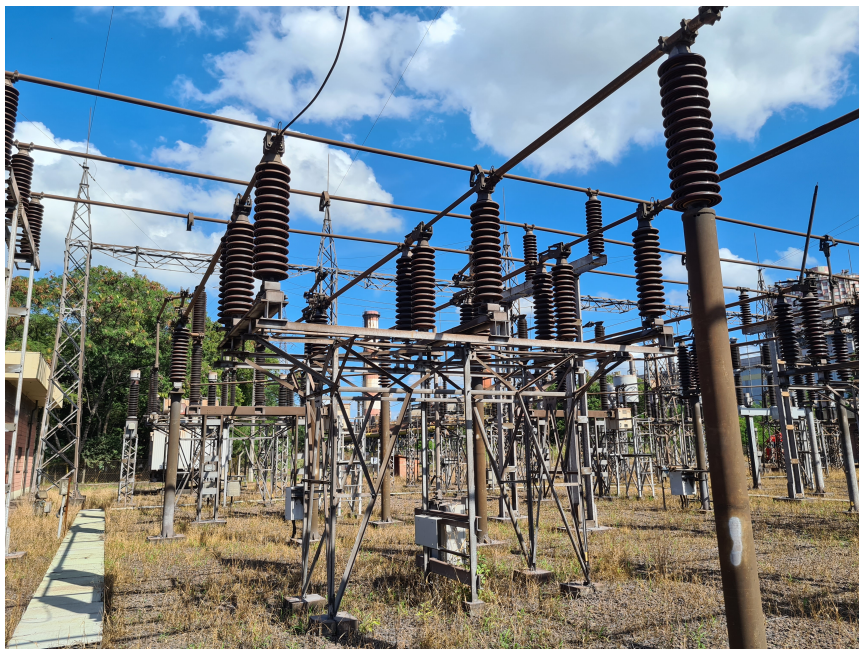
Figura 9 – Exemplos de barramento rígido.
