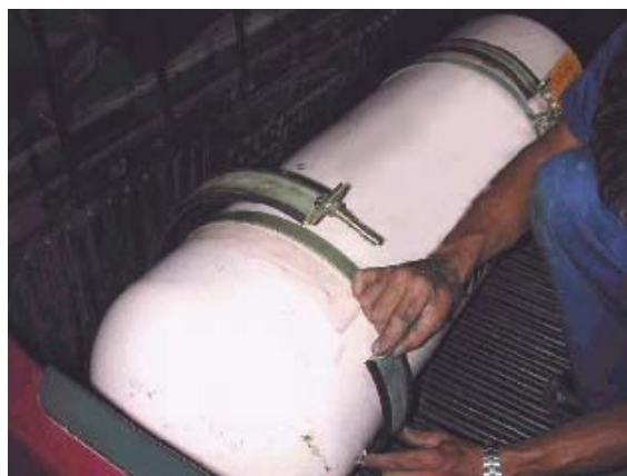
Figura 8.9 – Suporte dos cilindros de alta pressão
