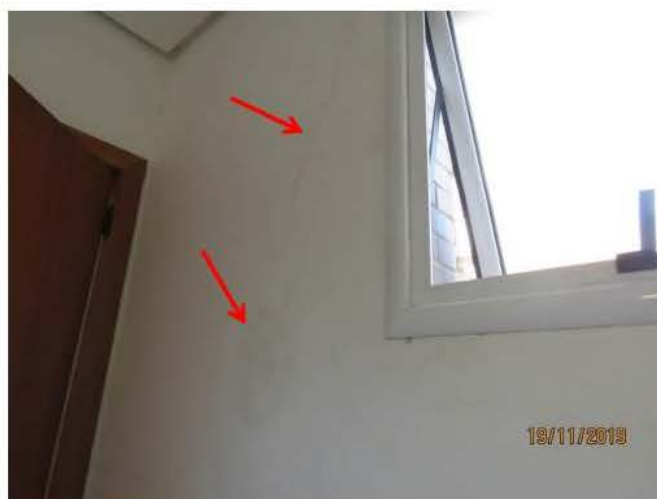
Foto 41 – Vista parcial da mesma parede indicada na foto anterior, porém, do outro lado da esquadria. Observam-se sinais de umidade e uma fissura em ângulo.
