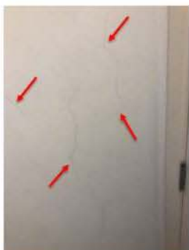
Imagem 77 – Fissuras em parede de alvenaria que faz divisa com coluna de exaustão de fumaça
