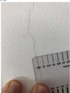
Imagem 85 – Fissura em parede de alvenaria com aproximadamente 0,05 mm
