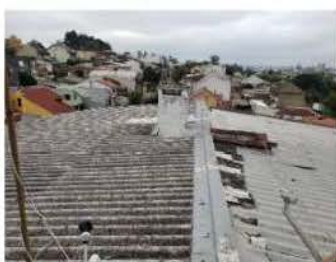
Foto 10: Falta de estanqueidade perto do fosso de luz.
