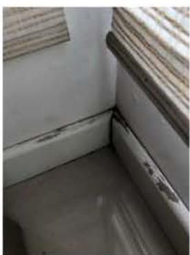
Imagem 83 – Sinais de infiltração em parede de alvenaria e marcas em rodapé sob janela de alumínio
