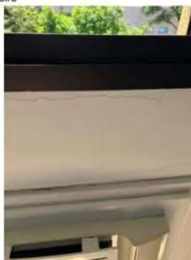
Imagem 86 – Fissura existente no perímetro inferior de janela de alumínio
