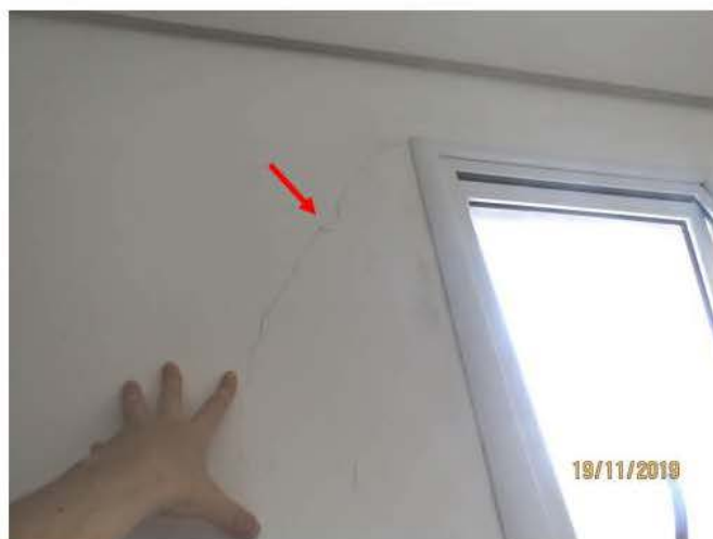
Foto 42 – Vista aproximada da fissura em ângulo da foto anterior.
