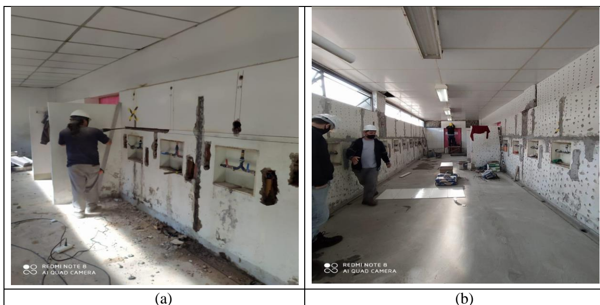
Figura 10: Obra Pirelli (a) Canaletas para Instalações Hidráulicas e (b) Assentamento de Porcelanato
