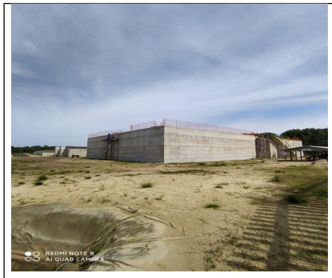
Figura 13: Estação de Tratamento de Esgoto Corsan - Tanque de Decantação
