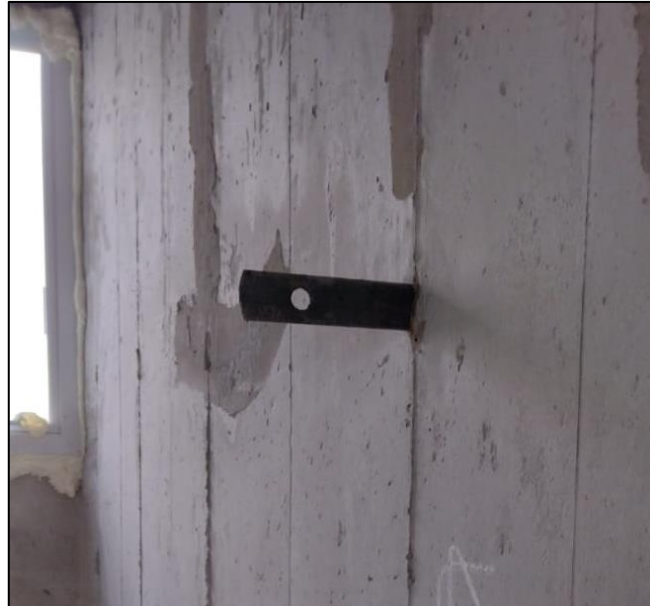
Figura 27 – Gravata na parede de concreto
