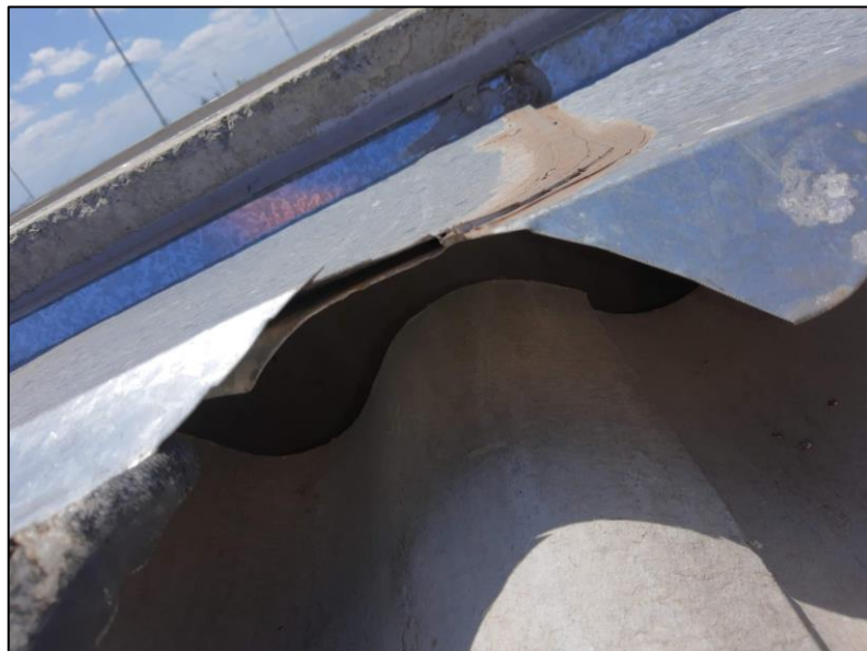
Figura 38 – Telha vista por baixo do rufo
