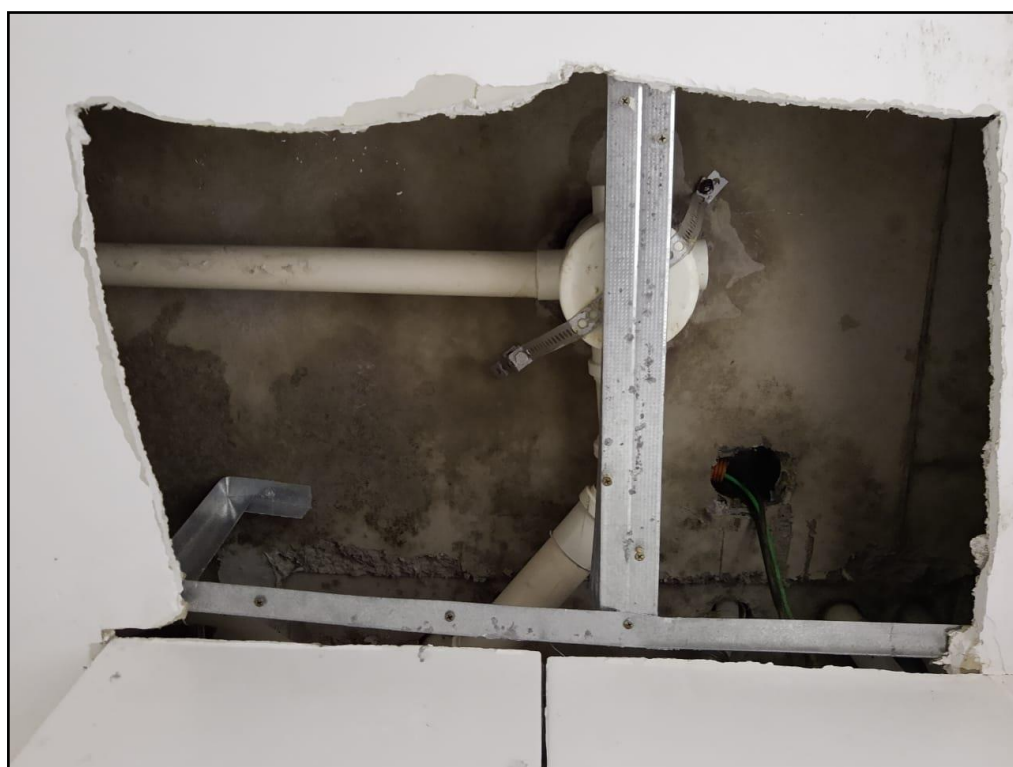
Figura 32 – Infiltração da laje superior do banheiro
