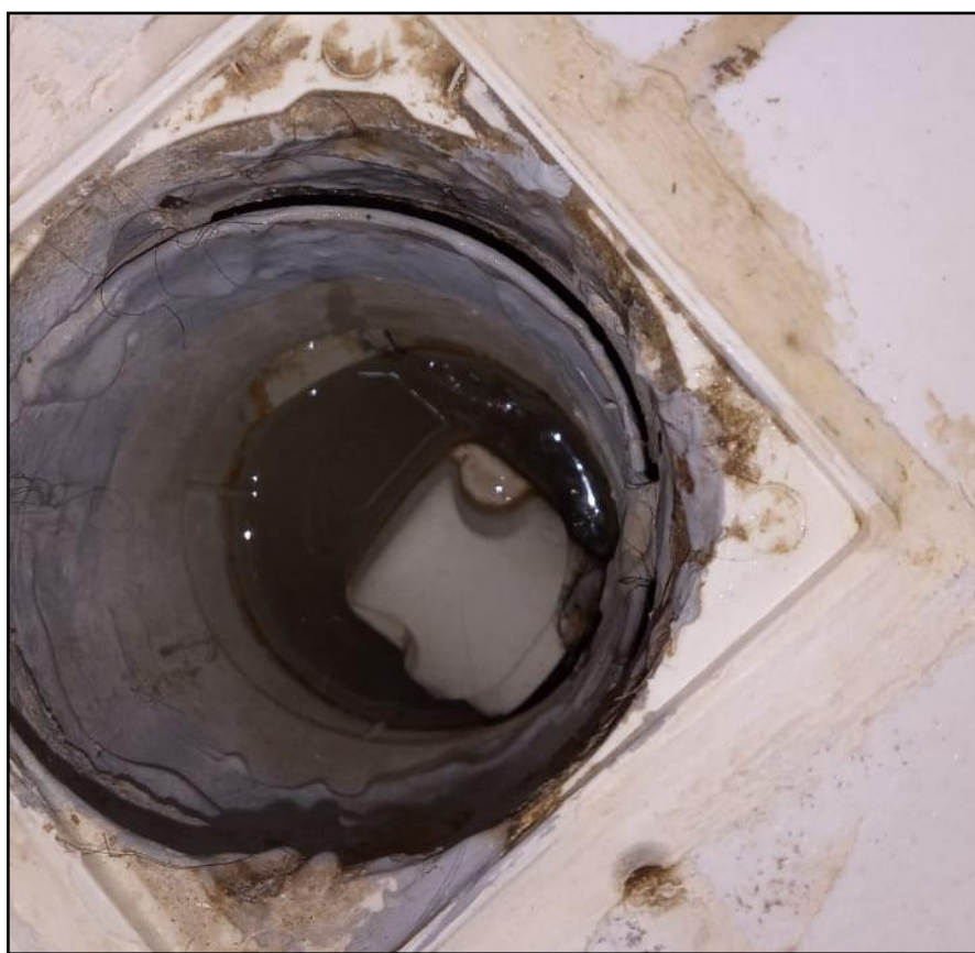
Figura 33 – Ralo box banheiro
