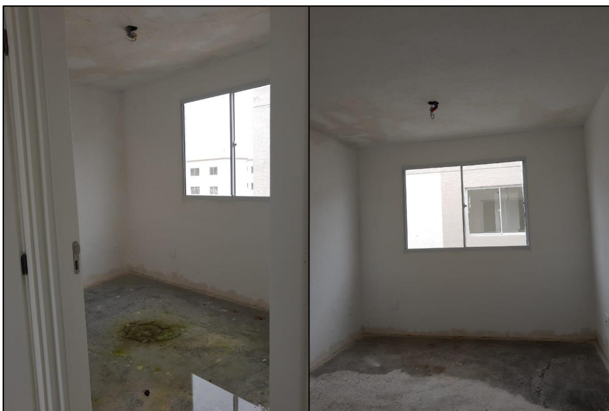
Figura 34 – Infiltração no teto dos dormitórios
