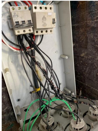
Figura 7: Cabos caixa elétrica derretidos
