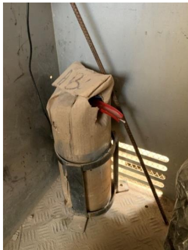
Figura 3: Extintor de incêndio localizado dentro do elevador cremalheira
