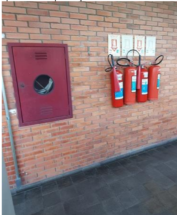
Figura 8 - Equipamentos de prevenção e combate a incêndio instalados
