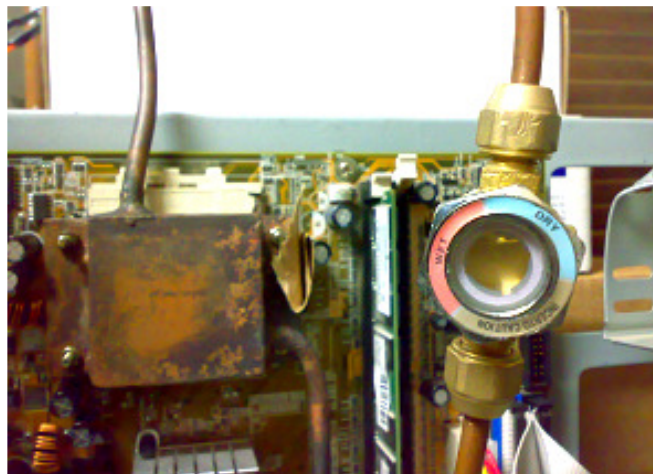
Figura 10: Visor de líquido instalado no sistema
