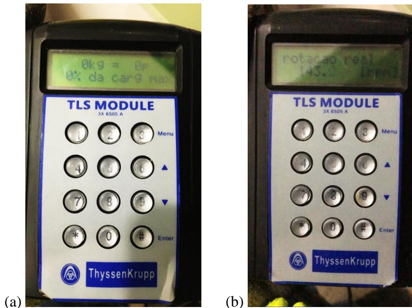
Figura 8 – (a) Carga presente na cabina durante os testes (0 kg) e (b) rotação real média de operação (143 RPM) da máquina de tração do elevador.
