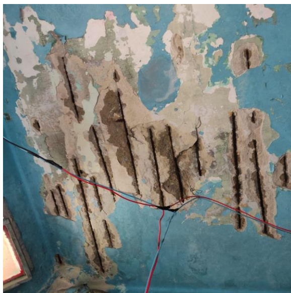
Figura 29: Armação da laje exposta no banheiro do 2º pavimento do edifício São Carlos
