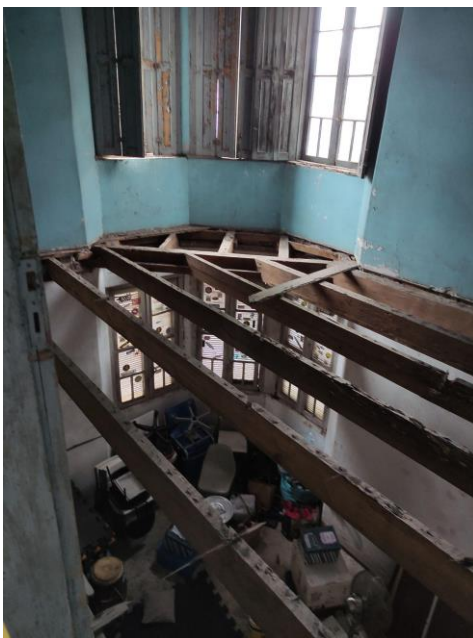
Figura 27: Exemplos de locais que necessitam reconstrução de entrepiso
