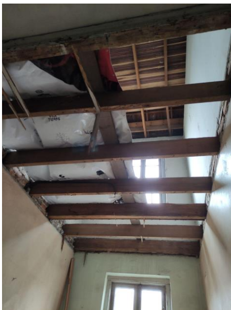
Figura 28: Exemplos de locais que necessitam reconstrução de entrepiso
