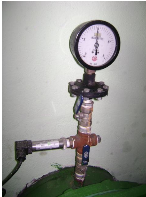
Figura 2: Manômetro MTR instalado dentro da estação elevatória. Fonte: Elaborado pela autora.
