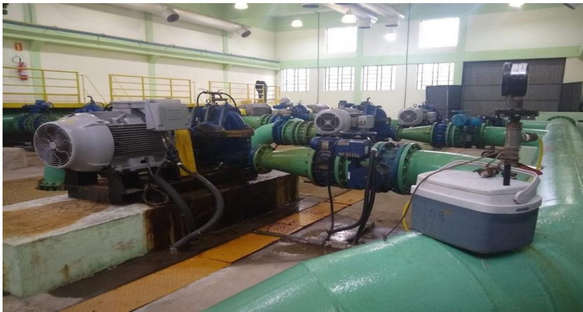
Figura 20: Datalogger instalado no recalque da EBAT Cascatinha/RES Caieira. Fonte: Elaborado pela autora.
