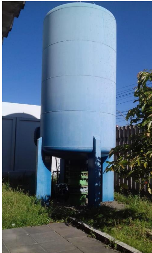
Figura 7: Reservatório hidropneumático, vaso pressão, localizado na EBAT Cascatinha na tubulação de recalque para o reservatório Caieira. Fonte: Elaborada pela autora.
