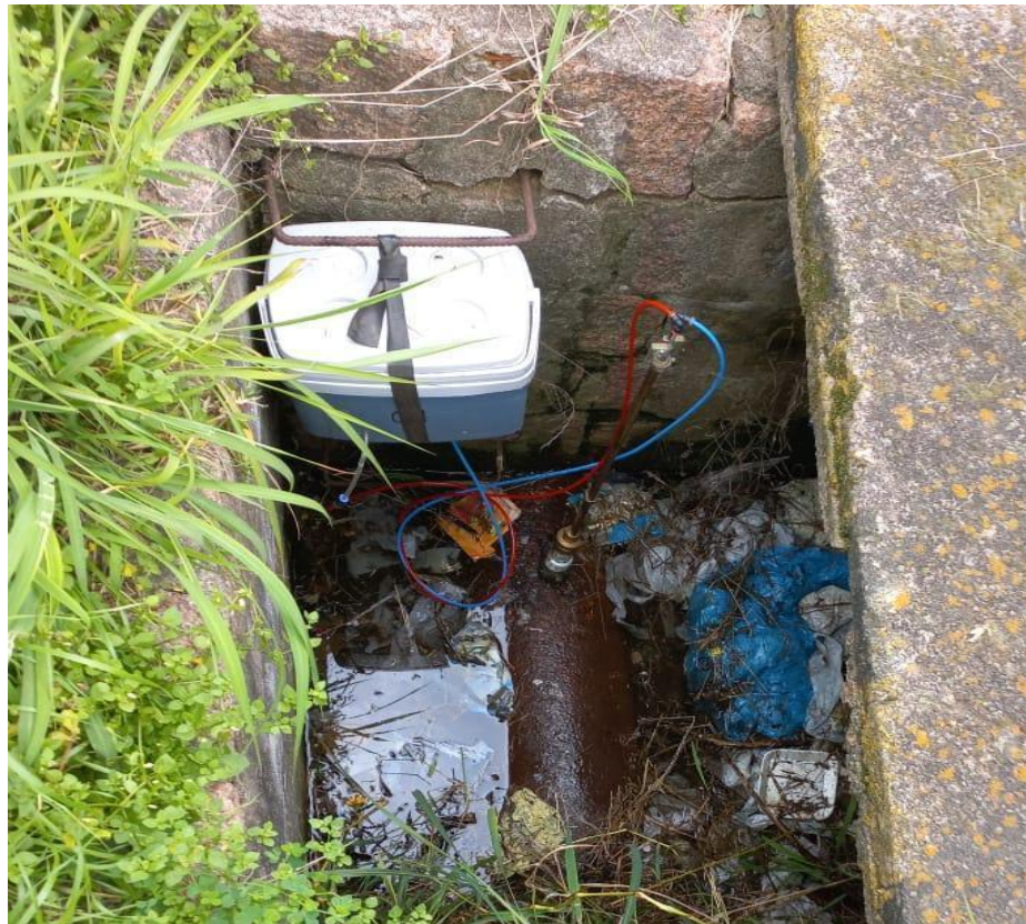
Figura 22: Exemplo de datalogger instalado com tubo pitot. Fonte: Elaborado pela autora.
