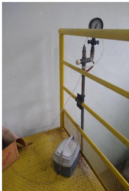
Figura 18: Datalogger instalado no recalque da EBAT Cascatinha/RES Catumbi. Fonte: Elaborado pela autora.
