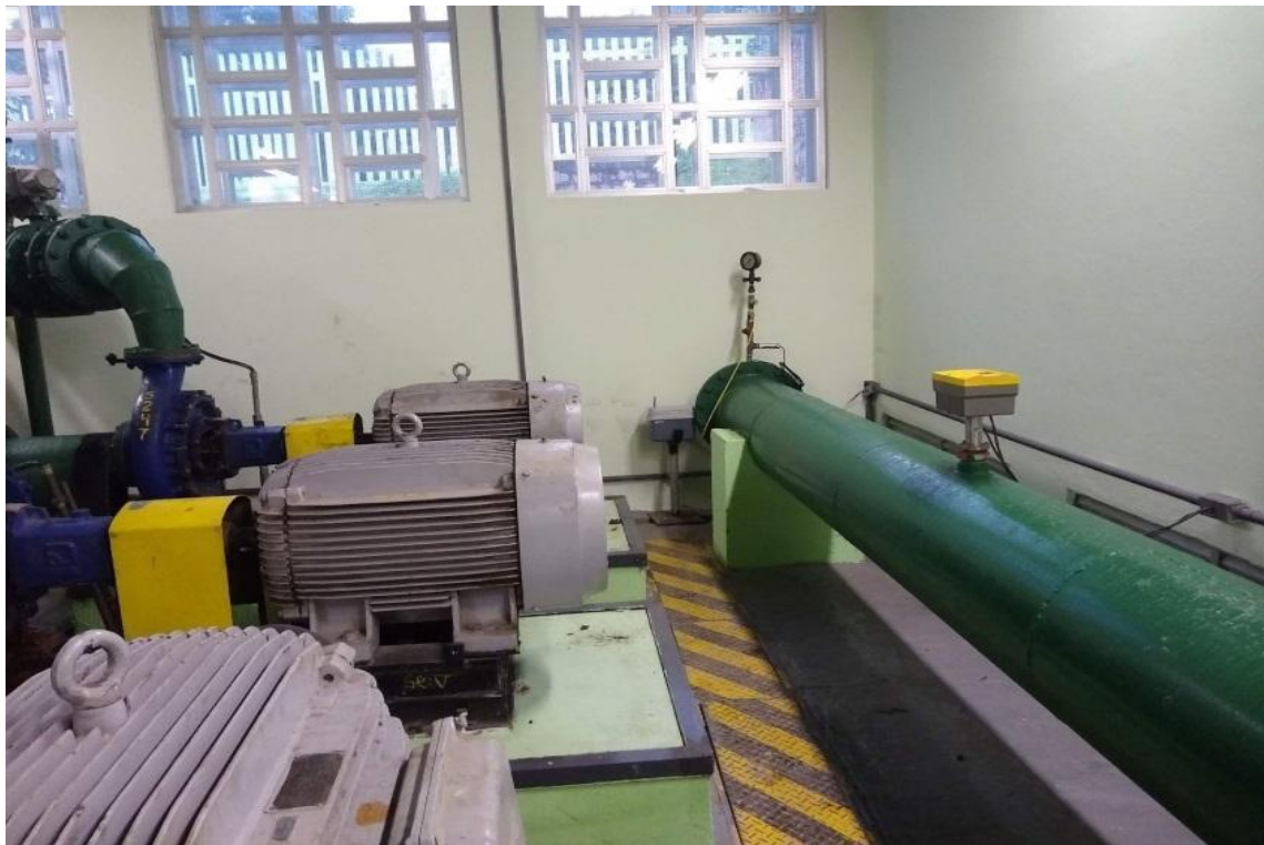
Figura 21: Datalogger instalado no recalque da EBAT Oscar Pereira/RES Primeiro de Maio. Fonte: Elaborado pela autora.
