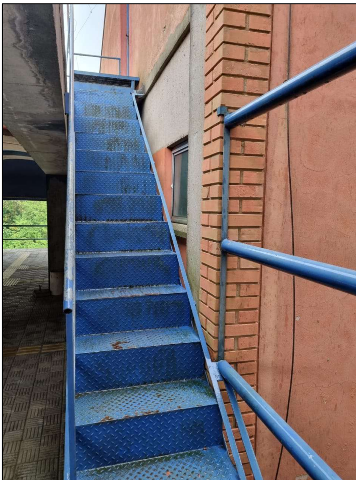
Figura 24: Acabamento das paredes da escada de acesso ao 3º pavimento do Prédio 43465.
