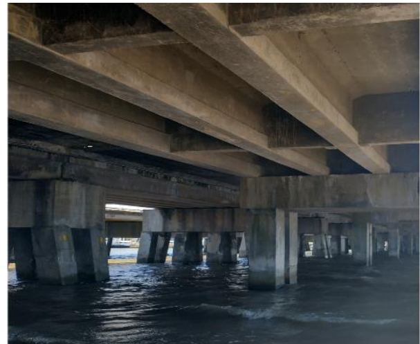
Figura 16 - Atual situação das vigas (Autor, 2022)
