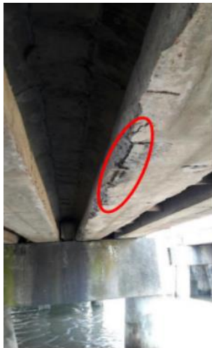
Figura 15 - Armadura longitudinal exposta (CARDOSO, 2018)
