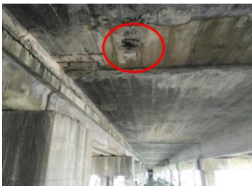
Figura 17 - Armadura da laje exposta (CARDOSO, 2018)
