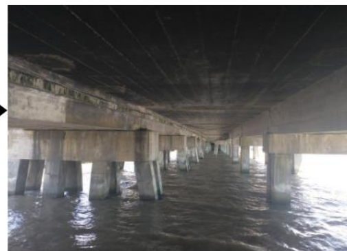
Figura 18 - Situação atual da laje (Autor, 2022)
