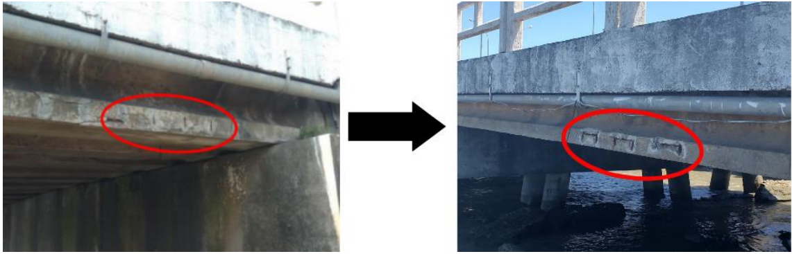
Figura 19 - Armadura transversal exposta (CARDOSO, 2018) Figura 20 – Armadura longitudinal exposta (Autor, 2022)
