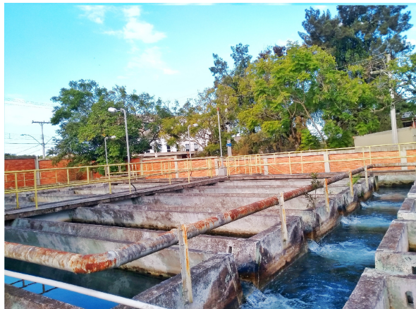
Figura 3.3: Decantador de manta de lodo da Estação de Tratamento de Água
