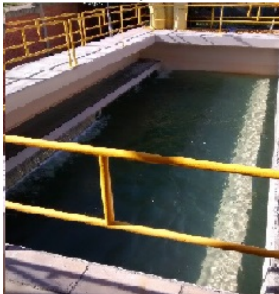
Figura 3.4: Filtro da Estação de Tratamento de Água
