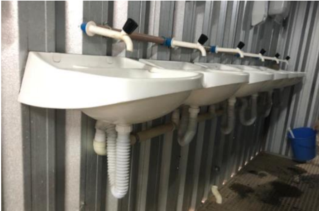
Figura 15 - Sistema de reutilização de água nos vestiários do canteiro
