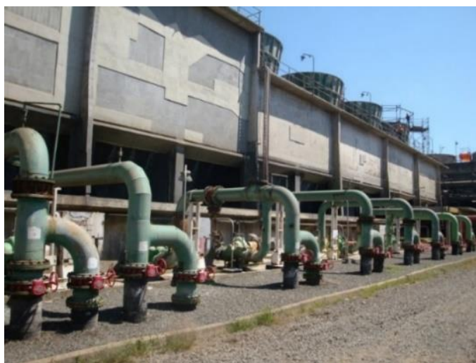
Fig. 1 – Sistema de bombeamento de água da torre de resfriamento
