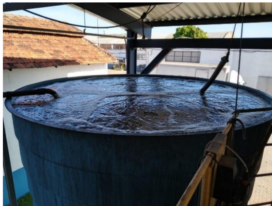
Figura 8: Reator Biológico SBR aerado
