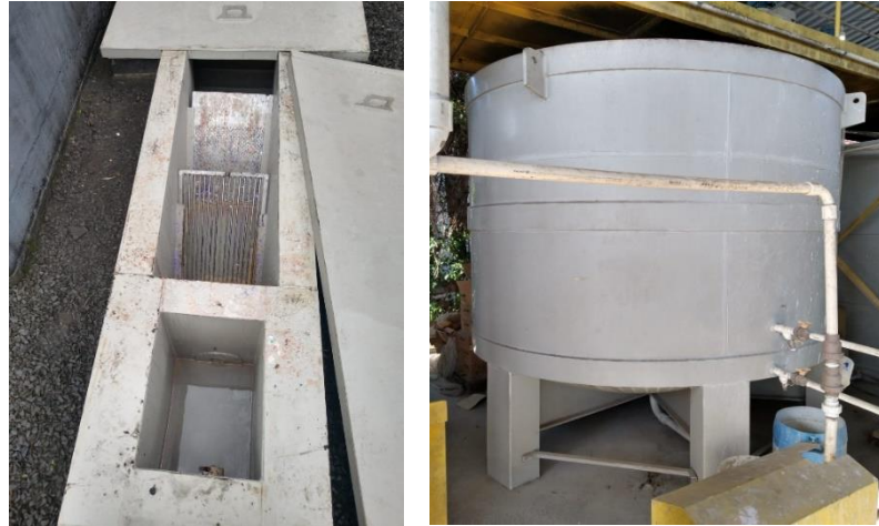
Figura 7: Sistema de Gradeamento para Remoção de Sólidos e Decantador Primário do Processo de Tratamento de Efluentes
