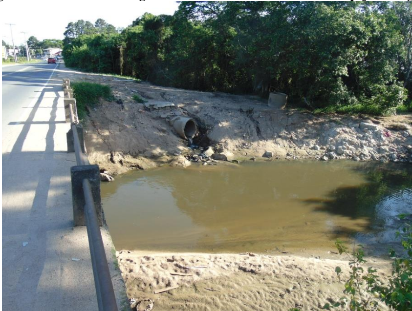
Figura 23 - Erosão das Margens Fluviais do Arroio de Salso e Despejo de Esgoto
