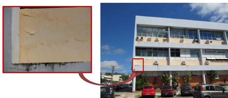
Figura 20 - Mancha de umidade no edifício 07 da UFSM, que comporta o Centro de Tecnologia
