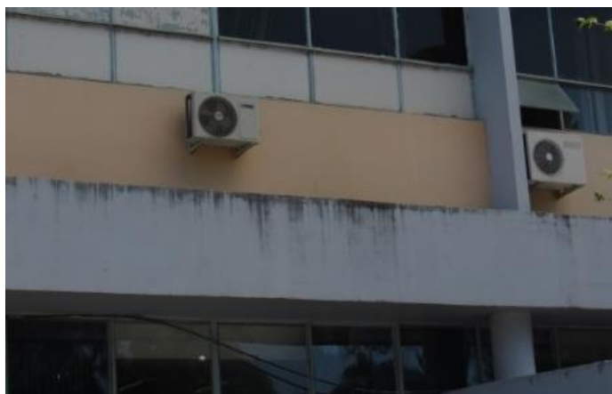
Figura 5 – Mancha de sujidade no edifício 07 da UFSM, que comporta o Centro de Tecnologia.
