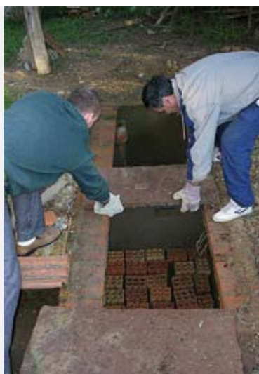
Figura 233 – Sistema modular, em construção, mostrando, à esquerda, os seus dois compartimentos (acima, digestor; abaixo, o filtro). À direita, o sistema modular sendo coberto por laje, onde também se observa o filtro (abaixo), executado com o uso de blocos de 6 furos
