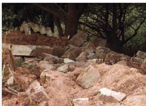
Figura 211 – Materiais reusados para as fundações (à esquerda, materiais descartados na substituição de pavimentos do campus Central da UFRGS; à direita, restos de demolição de construção preexistente ao lado do lote destinado ao protótipo), em 02/01/02
