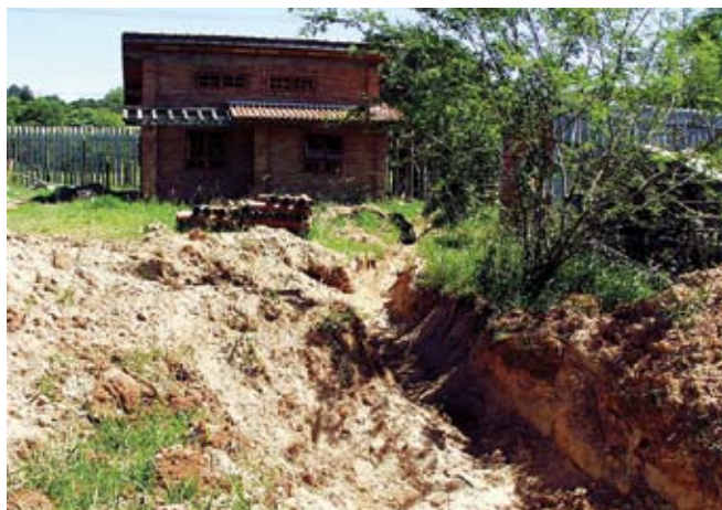
Figura 228 – Implantação do sistema de tratamento de águas residuárias do protótipo Casa Alvorada (vista a partir do leito de evapotranspiração, em execução)
