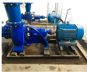
a) conjunto moto-bomba
