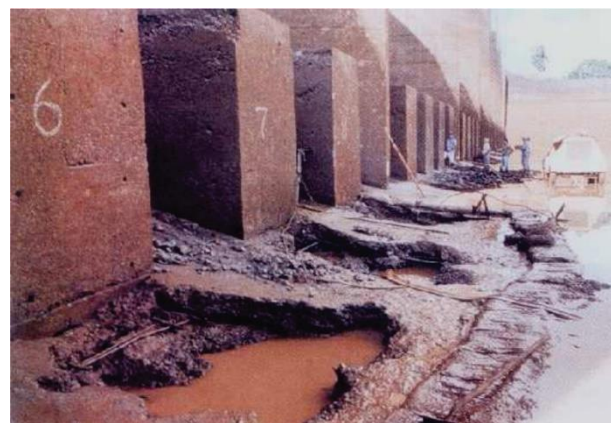
Figura 65 – Danos por cavitação na bacia de dissipação da UHE Porto Colômbia. Fonte: Teixeira (2008)
