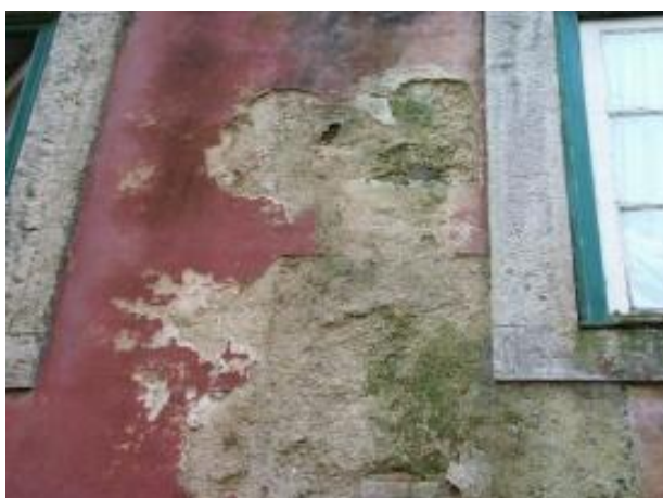
Figura 7 – Perda de coesão ou desagregação
