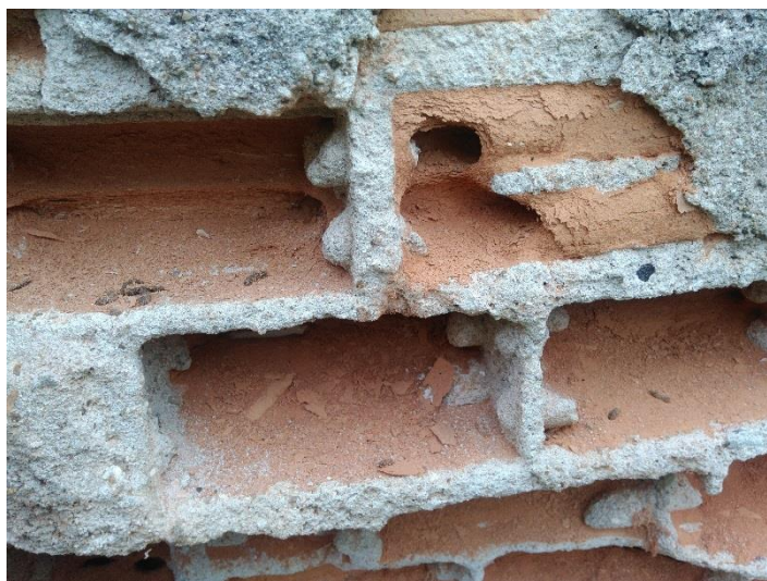
Figura 20 – Criptoflorescência em alvenaria
