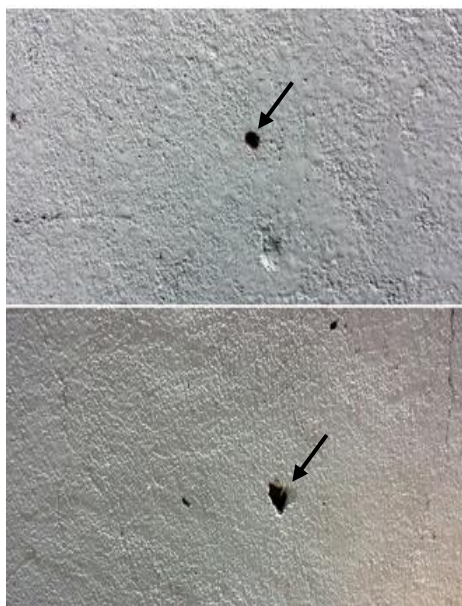
Figura 12 – Vesículas em revestimento de argamassa
