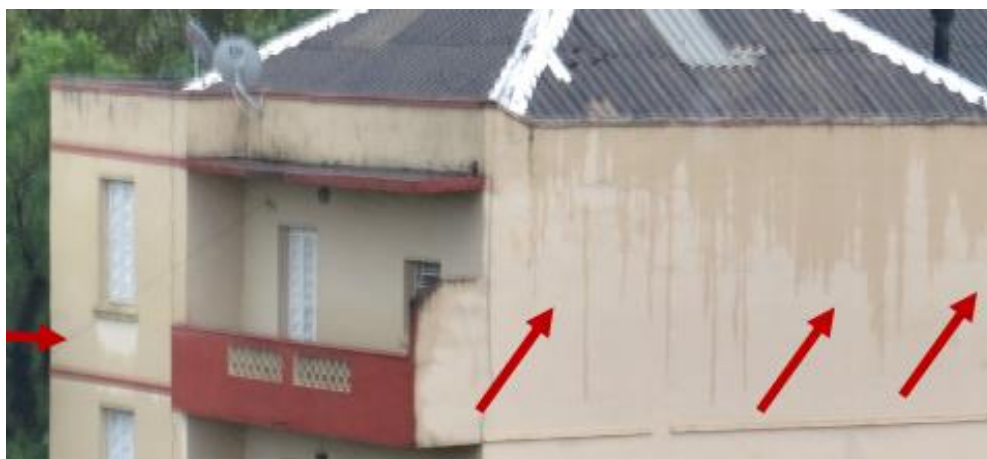
Figura 17 – Manchas de umidade por chuva dirigida na fachada
