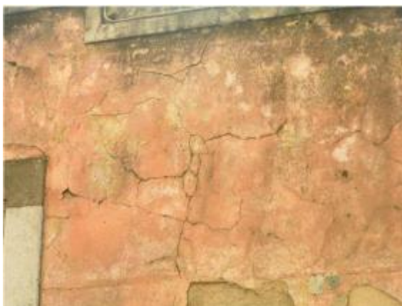
Figura 9 – Fissuras no revestimento de argamassa
