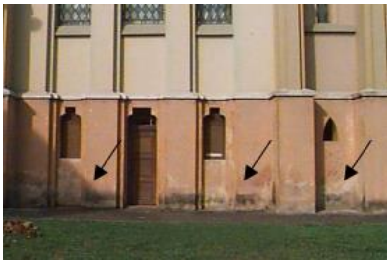
Figura 18 – Horizonte de capilaridade em fachada
