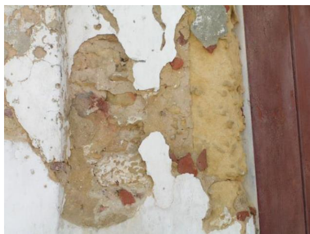
Figura 8 – Perda de coesão ou desagregação
