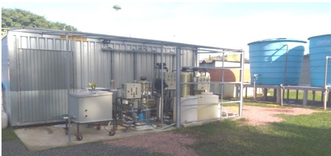
Figura 2: Unidade piloto de reúso.
