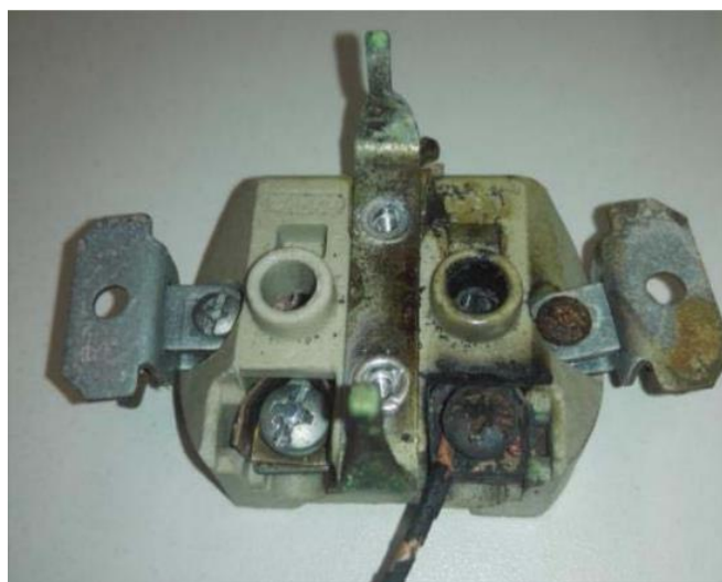
Figura 1 - Ponto de aquecimento com formação de óxido metálico.
