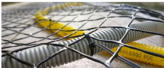
Figura 23: Eletrodutos de 2,5 centímetros de espessura, presos à tela por abraçadeiras de nylon pretas. Fonte: Stefanello Studio .
