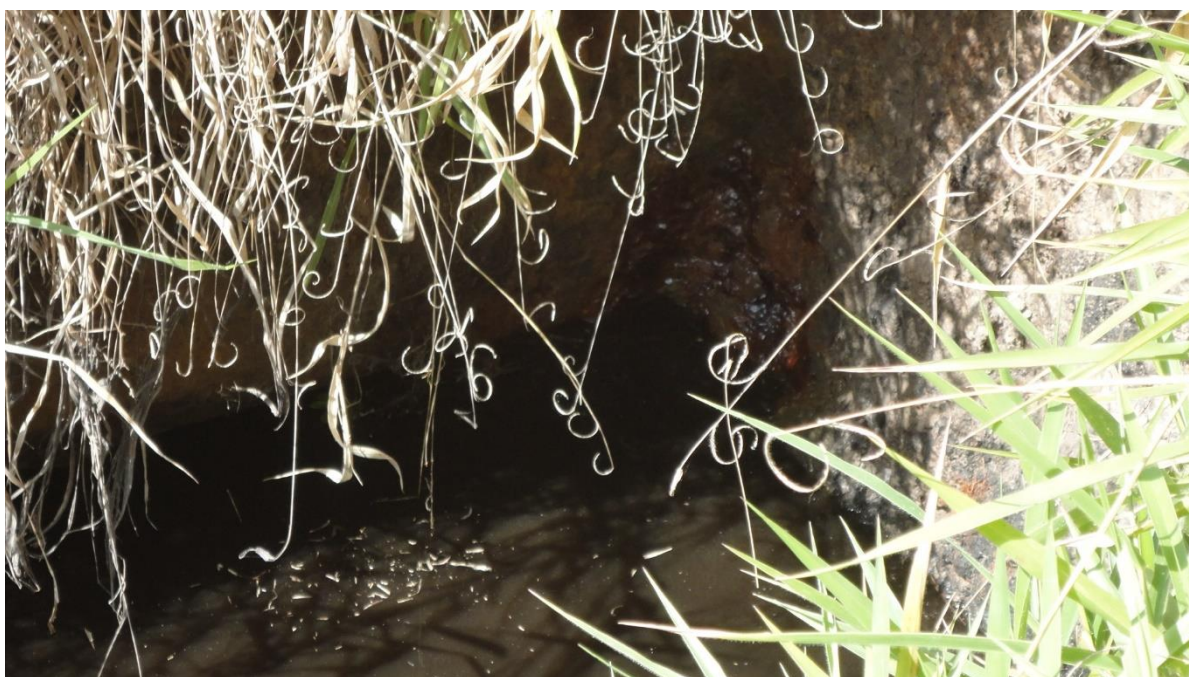
Figura 2 – problema de infiltração no maciço do barramento. Fonte: acervo pessoal Cesar Alberto Ruver
