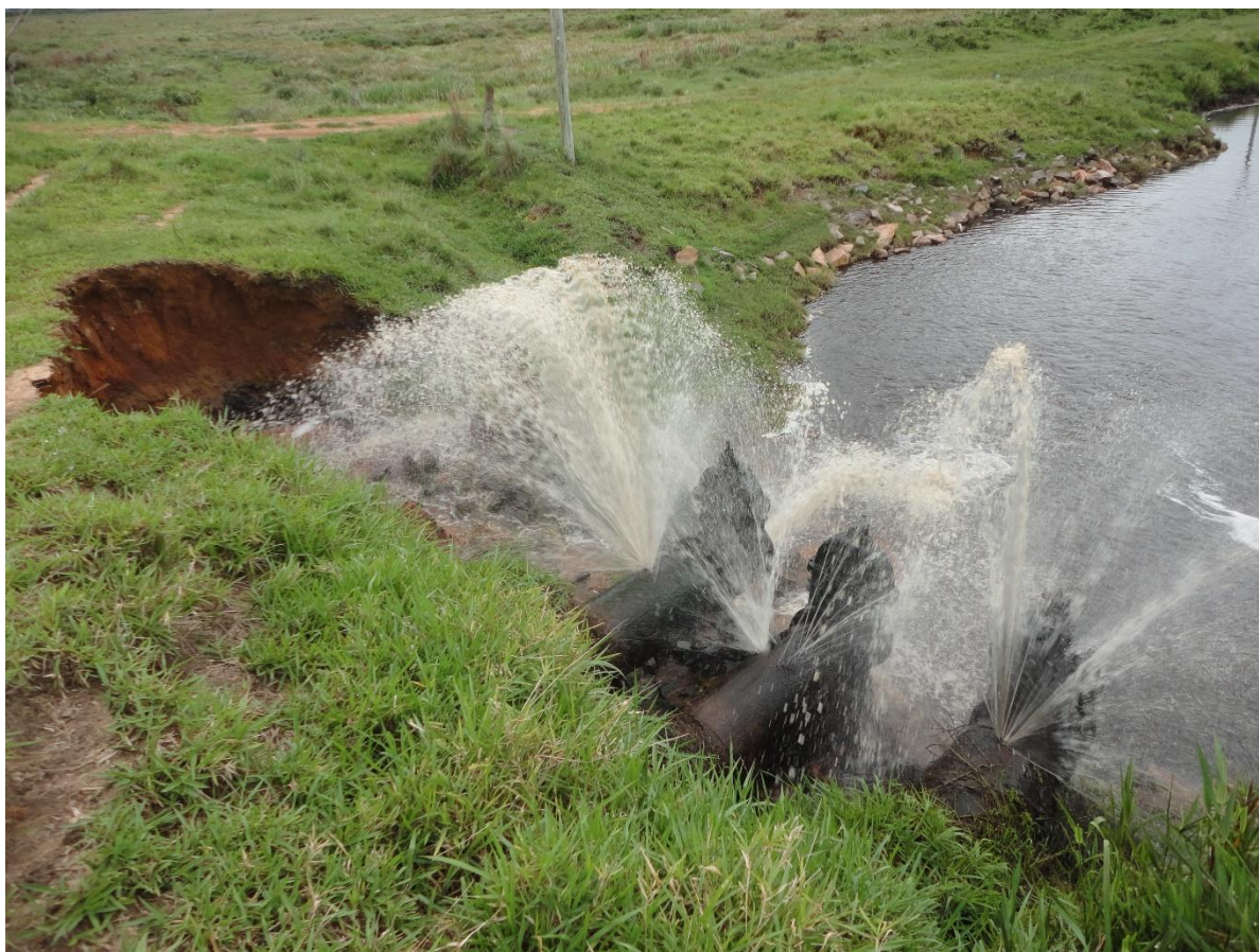
Figura 3 – vazamento das comportas de irrigação. Fonte: acervo pessoal Cesar Alberto Ruver
