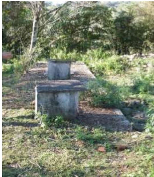
Figura 19 - Sistema de tratamento de esgoto
