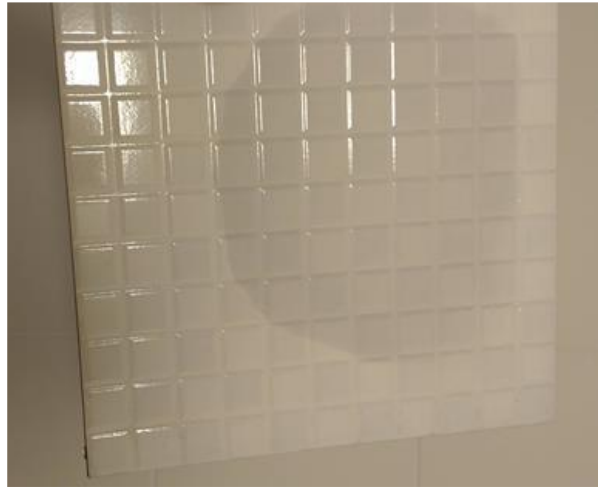
Figura 16 - Mancha d'água em placa cerâmica
