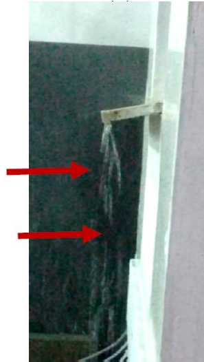
Figura 24 - Fluxo de água no perfil lateral de peitoril com inclinação de 20% e projeção frontal de 12cm
