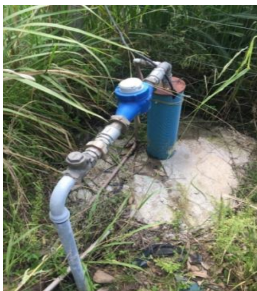
Figura 10: Ponto de captação de água subterrânea
