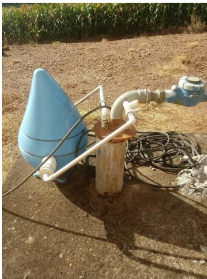
Figura 15: Poço com sistema de cloração instalado.
