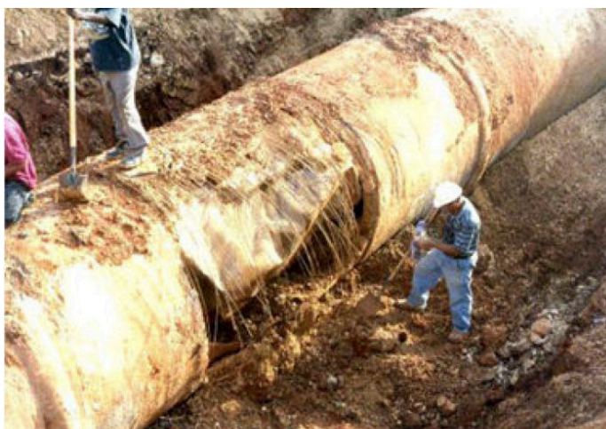
Figura 3.8 - Rompimento em aqueduto em Porto Rico, ocasionado por transiente hidráulico. Fonte: Abuiziah, et al. 2013.
