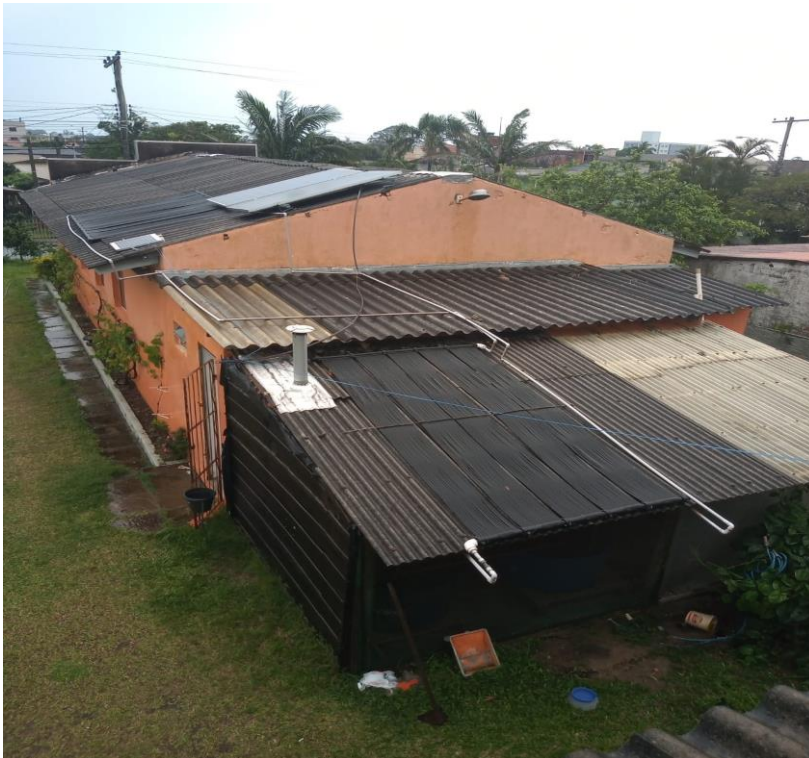
Imagem 11 – Sistema elétrico e de aquecimento solar instalados.
