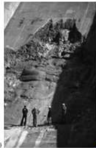
Figura 19 – Danos de cavitação em vertedouro de calha lisa na Barragem de Shahid Abbaspour.
